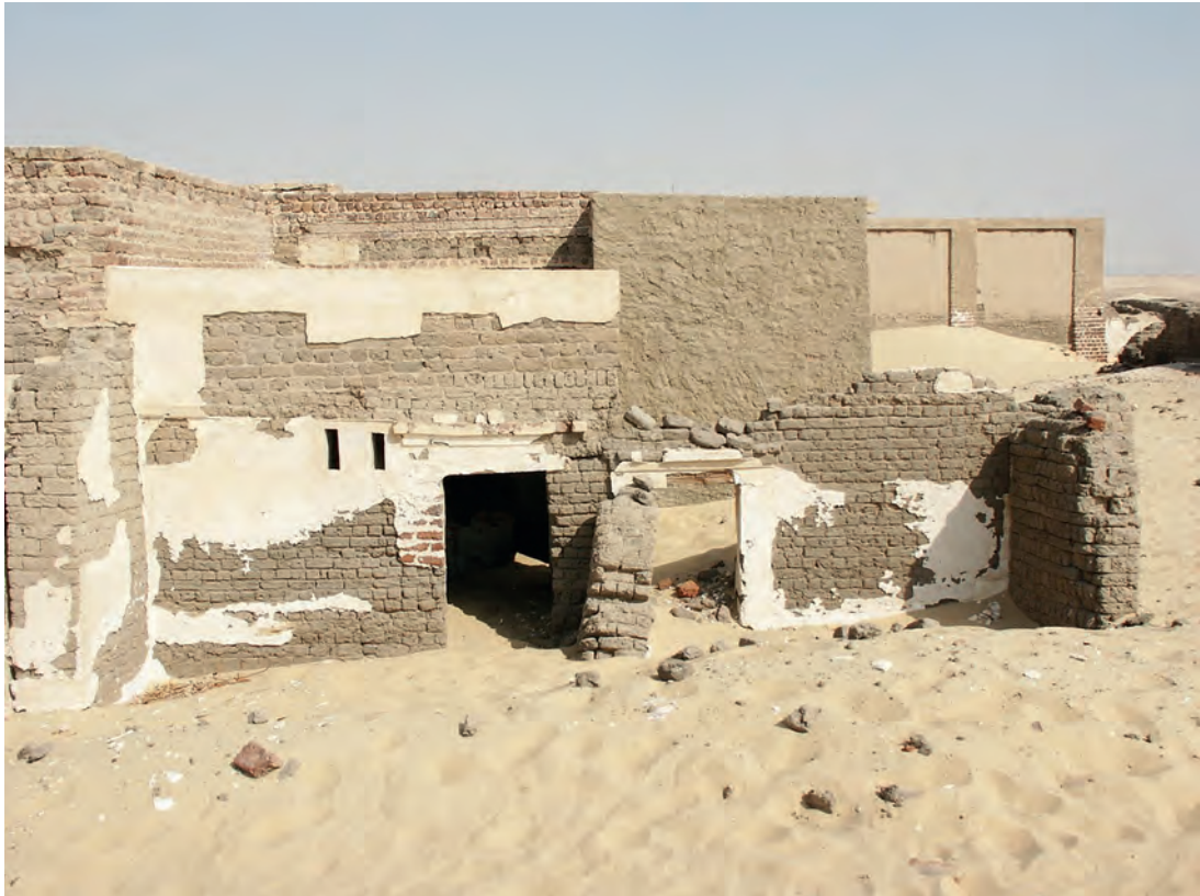
Abb. 1: Ansicht der Südfassade mit Vorhalle (GB 5.2.3–5.2.4) vor Beginn der Arbeiten im Jahr 2006
