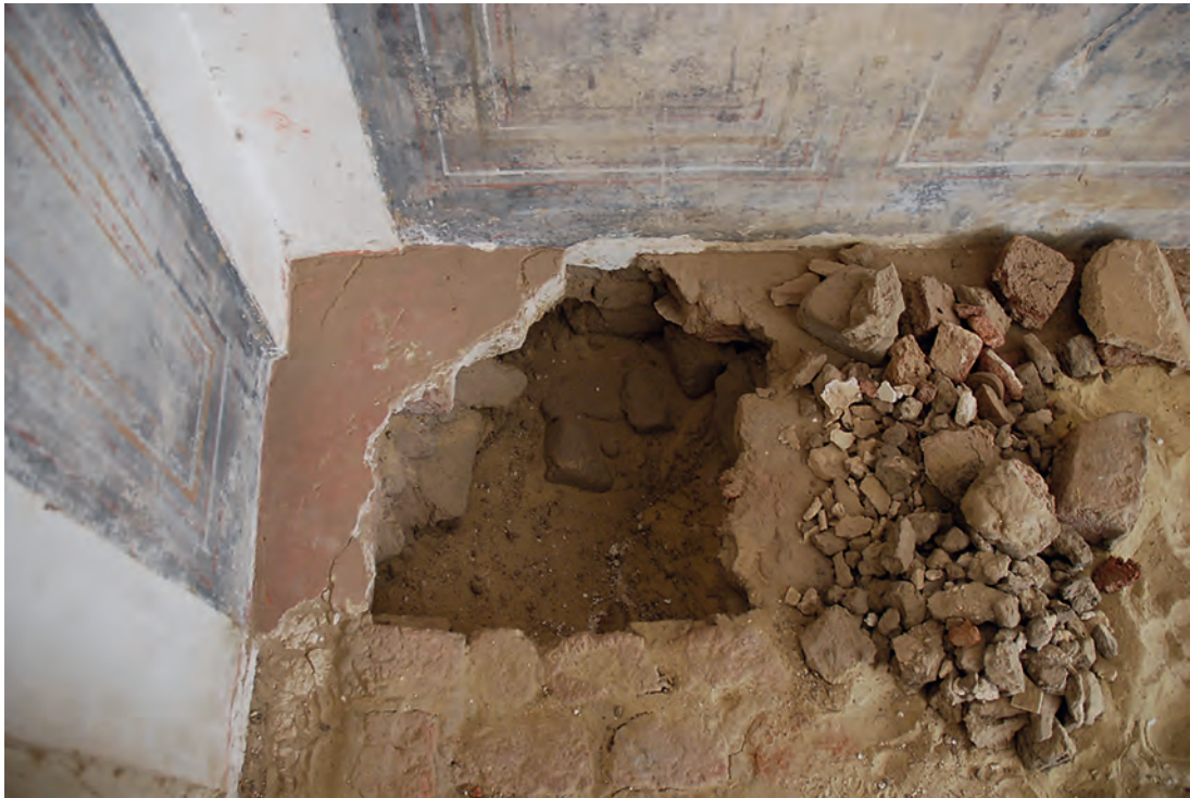
Abb. 14: Hauptraum, Ausbruch im Fußboden in Südwestecke; 2009
