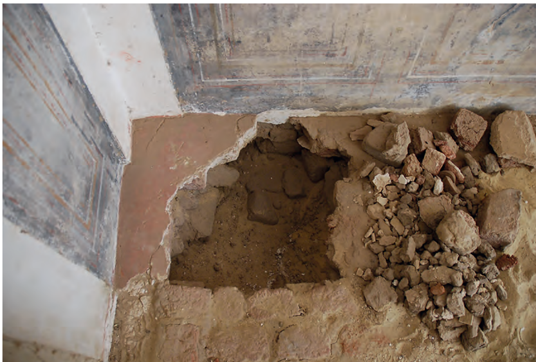
Abb. 14: Hauptraum, Ausbruch im Fußboden in Südwestecke; 2009
