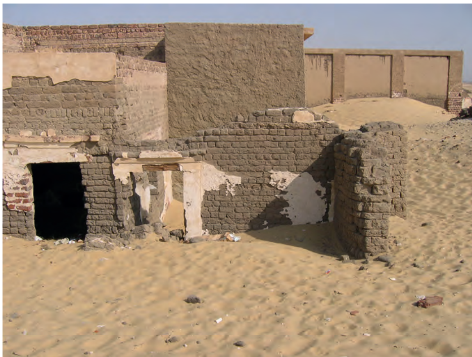
Abb. 10: Südfassade (GB 5.2.3), östliche Hälfte mit dem Zugang zu Raum GB 5.2.1 (= bauzeitlicher Haupteingang in das Geschoss GB 5.2); 2007
