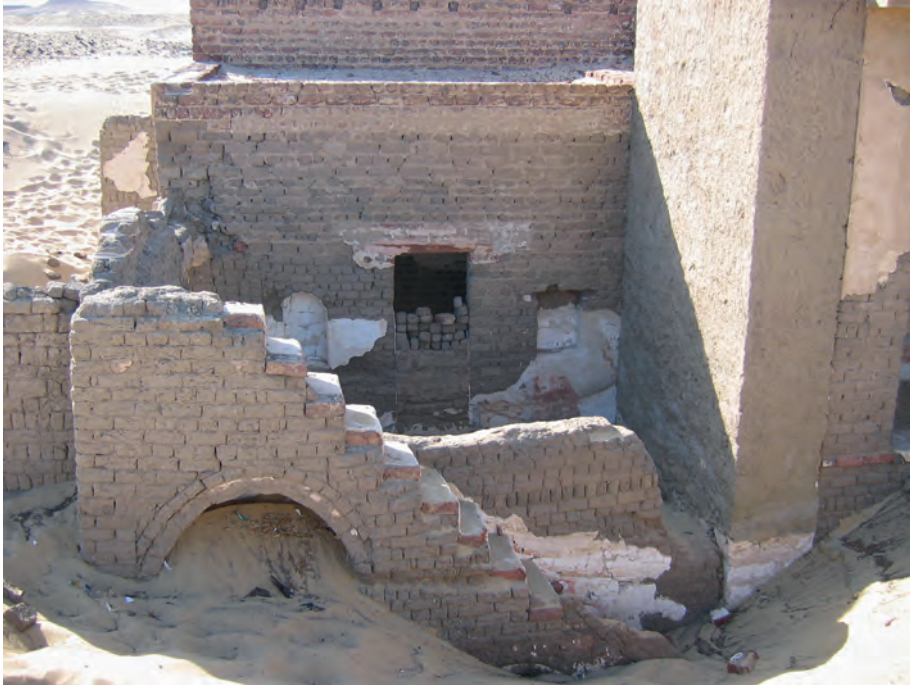
Abb. 12: GB 5, Ostansicht. Straßentreppe zum oberen Geschoss und dahinter die Ostfassade mit Resten des ursprünglichen Fassadenputzes. Rückseitig Raum GB 5.2.1 mit der Westwand und zentraler, zugesetzter Tür zu Raum GB 5.2.2, zwei Nischen und Wandmalereiesten; 2006
