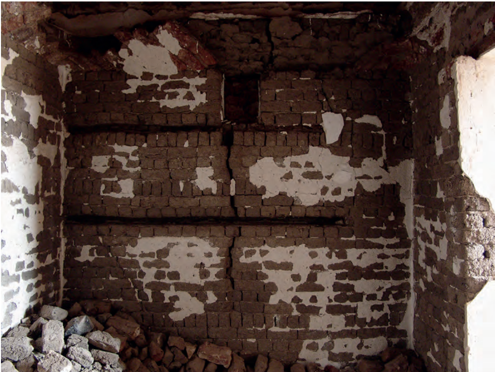
Abb. 26: Raum GB 7.2.3, Holzbewehrung in der Nordwand; 2006
