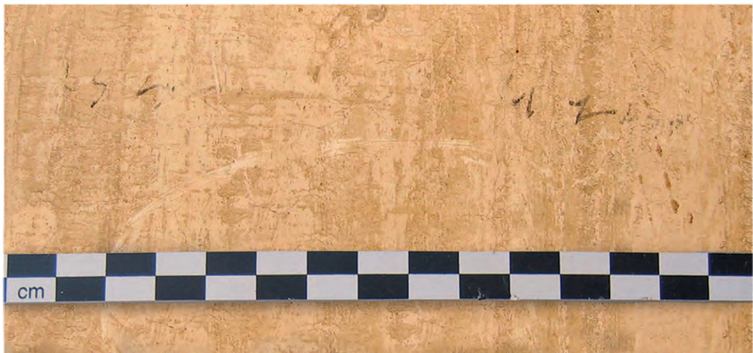
Abb. 29: Raum GB 6.2.2, Detailaufnahme der Graffiti; 2010
