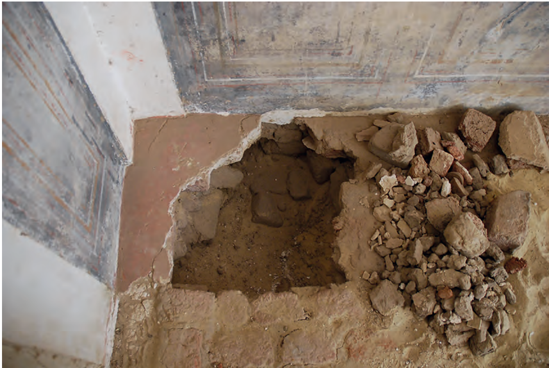
Abb. 14: Hauptraum, Ausbruch im Fußboden in Südwestecke; 2009
