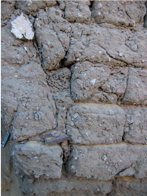
Abb. 16: GB 5, Straßentreppe aus ungebrannten Ziegeln. Hoher, südlicher Substruktionsbogen mit Keramikscherben in den Stoßfugen; 2006
