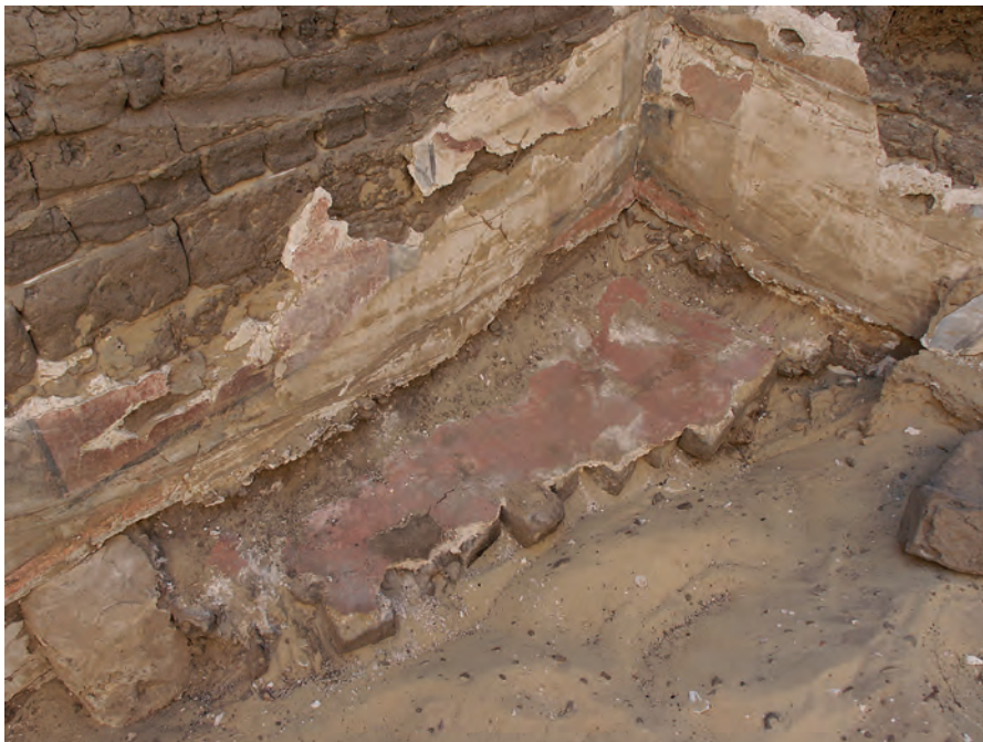
Abb. 18: Raum GB 5.2.1, Südostecke mit abgesacktem Fußboden und Wandmalerei. Die Estrichkanten der Süd- und Ostwand zeigen die ursprüngliche Fußbodenhöhe an; 2006
