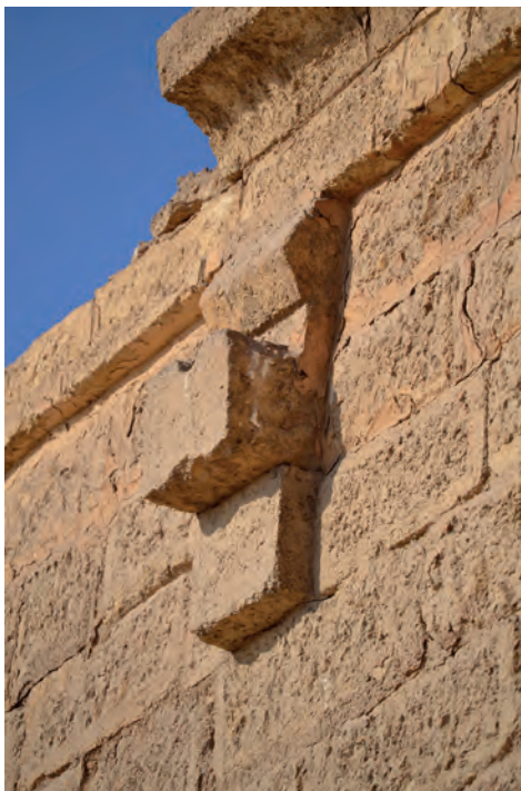
Abb. 6 a: Wasserspeier an GB 48, Seitenansicht; 2021
