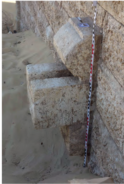
Abb. 4 a: Wasserspeier an GB 14, Ansicht von Süden; 2021
