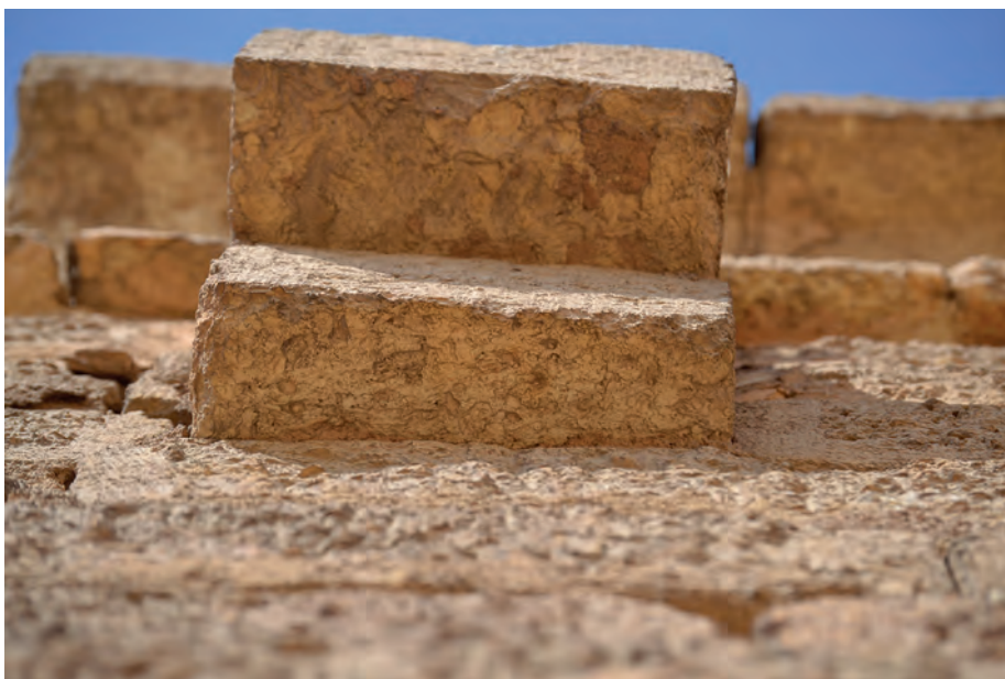
Abb. 6 c: Wasserspeier an GB 48 von unten, deutlich sichtbar ist die leicht schiefe Anbringung; 2021
