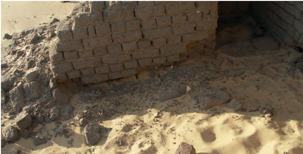
Abb. 11: GB 200.2.1, Südwand, horizontal verlaufende Fehlstelle am Wandfuß der Trennwand zwischen GB 200.2.1 und dem Treppenhaus mit dem Abdruck des verrotteten Holzunterzugs; 2010
