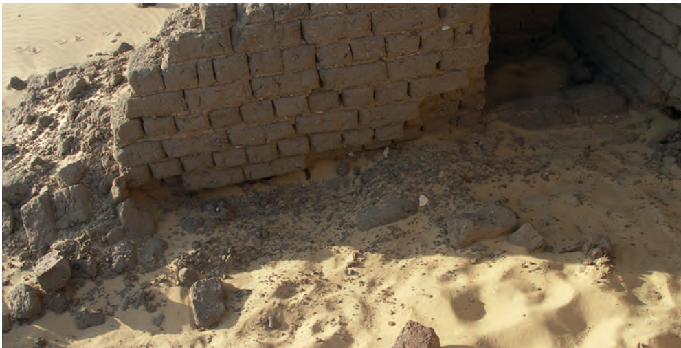
Abb. 11: GB 200.2.1, Südwand, horizontal verlaufende Fehlstelle am Wandfuß der Trennwand zwischen GB 200.2.1 und dem Treppenhaus mit dem Abdruck des verrotteten Holzunterzugs; 2010
