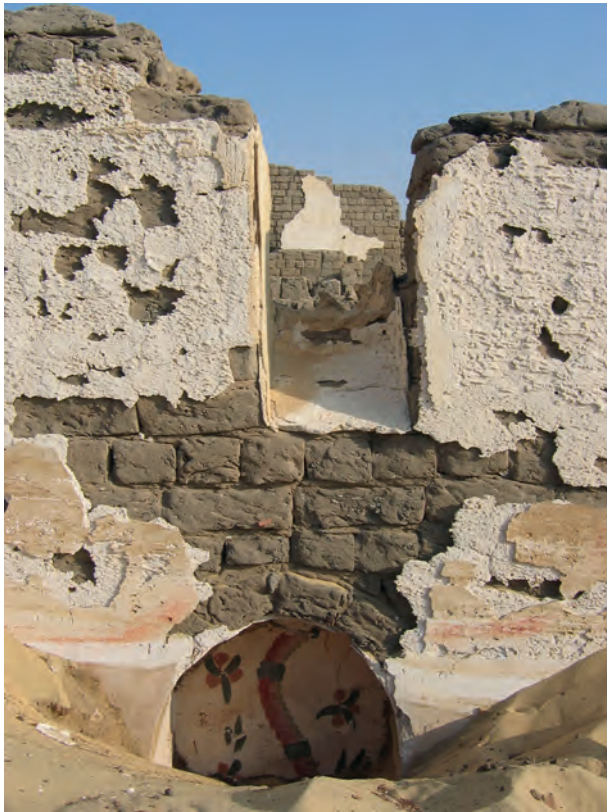
Abb. 15: GB 201.1.2, Nordwand, Fensteröffnung, Rundbogensische und Wandmalerei. In der Fensteröffnung ist der untere Teil des Fenstergitters in situ erhalten; 2010
