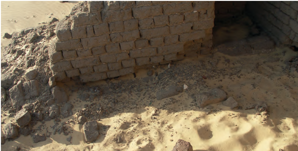
Abb. 11: GB 200.2.1, Südwand, horizontal verlaufende Fehlstelle am Wandfuß der Trennwand zwischen GB 200.2.1 und dem Treppenhaus mit dem Abdruck des verrotteten Holzunterzugs; 2010
