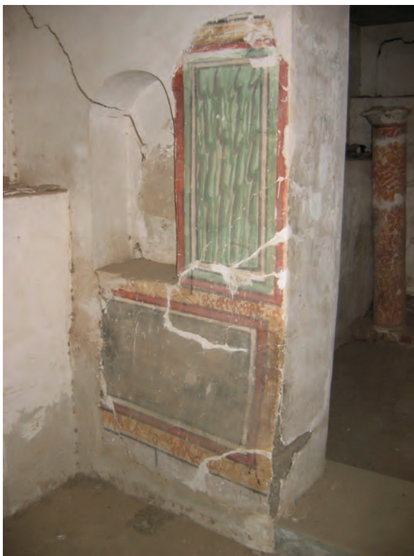
Abb. 11: GB 13, Obergeschoss, 1. Raum, östliche Süd- wand; 2006
