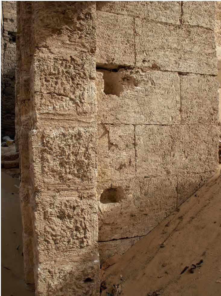
Abb. 12: Verriegelungslöcher in der Eingangstür (östliche Laibung); 2007
