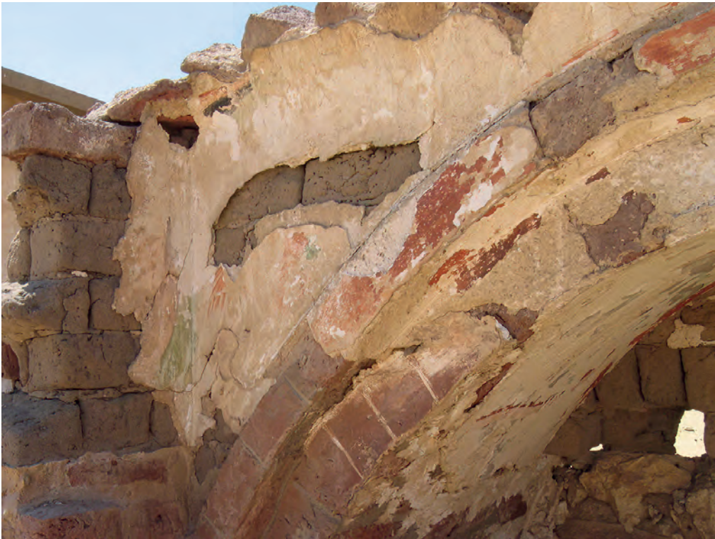
Abb. 21: Südliches Arkosol, südlicher Bogenzwickel; 2005
