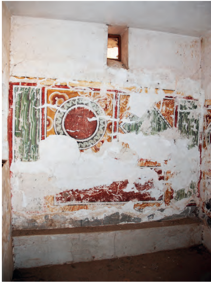
Abb. 15: GB 12, Obergeschoss, 1. Raum, Westwand; 2008
