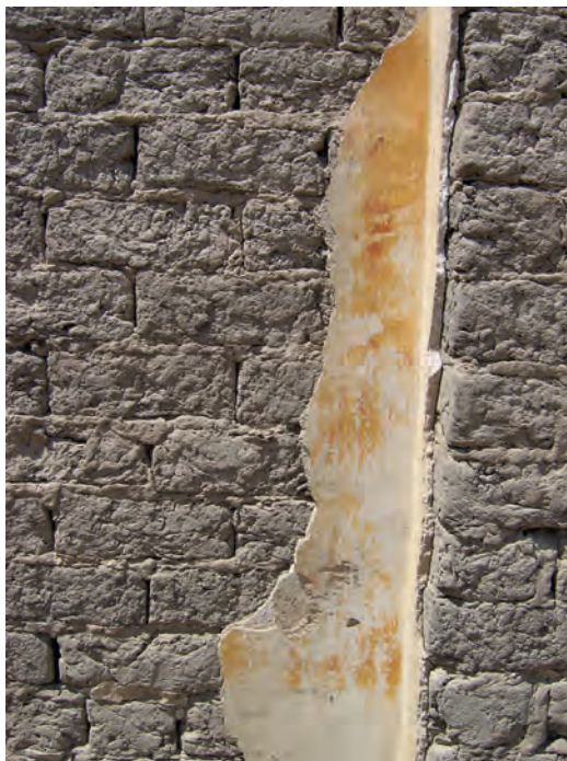
Abb. 27: GB 16, Obergeschoss, Vorhalle, Reste von Wandmalerei an der Nordwestecke, Detail; 2005
