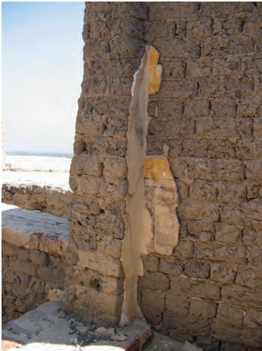
Abb. 25: GB 16, Obergeschoss, Vorhalle, Reste von Wandmalerei an der Nordostecke, Detail; 2005
