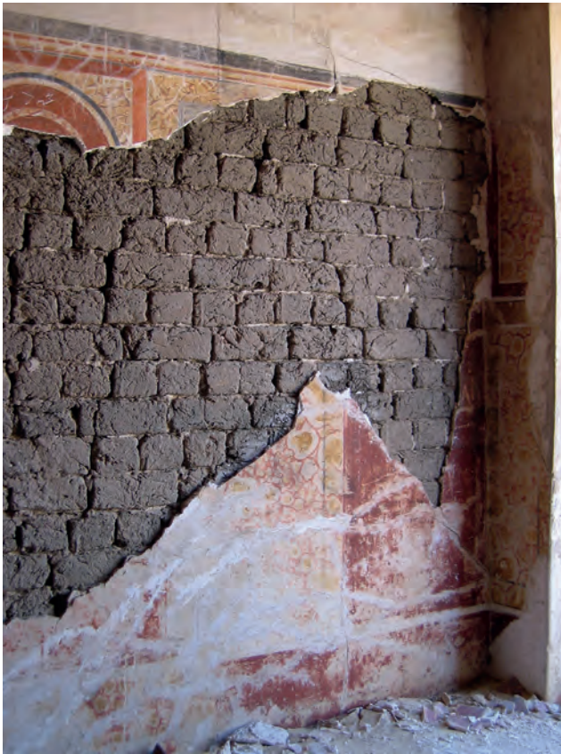
Abb. 4: GB 16, Obergeschoss, erster Raum, Westwand; 2005
