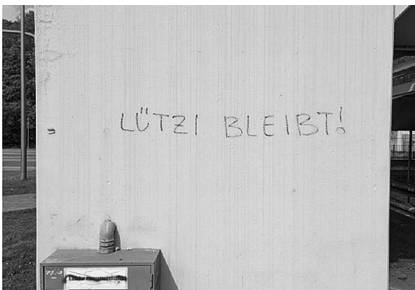
Abb. 11: Nordwestliches Treppenhaus von Parkhaus 3 (Außenwand).
