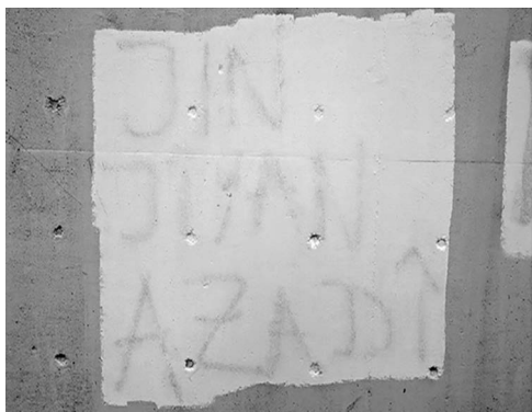
Abb. 3: Unter der Farbe erkennbares Graffiti an der Rampe neben dem Haupteingang des UHG.
