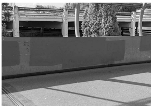
Abb. 2: Brückengeländer mit Flächen neuer Farbe, die u.a. „Jin, Jiyan, Azadi“-Graffitis aus dem vorangegangenen Semester überdecken.
